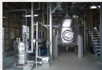
定置型水素製造装置
