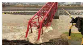
長野県上田市 橋梁が倒壊し、鉄道が不通となりました。
