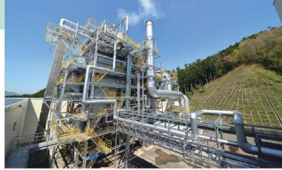
提供：真庭市 バイオマス発電所
